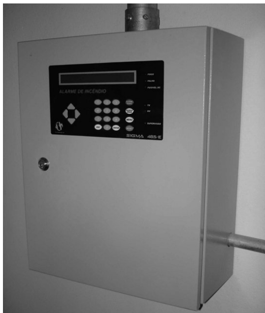
Figura 60 - Central de alarme
