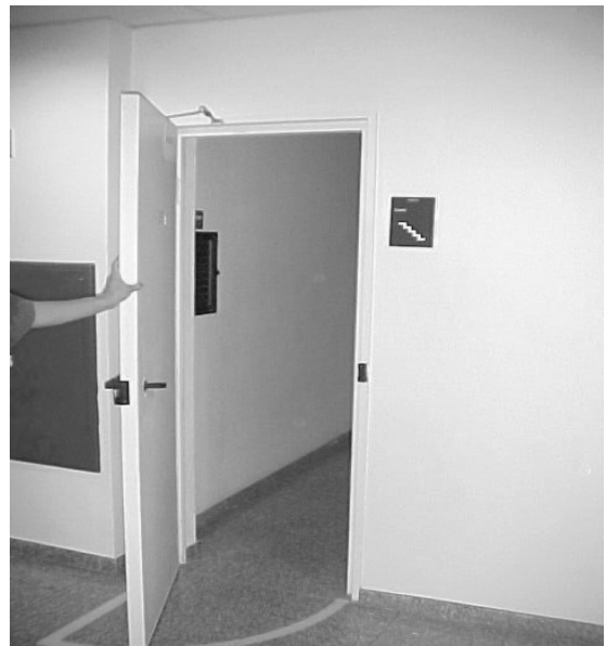
Figura 52 - PCF em corredor
