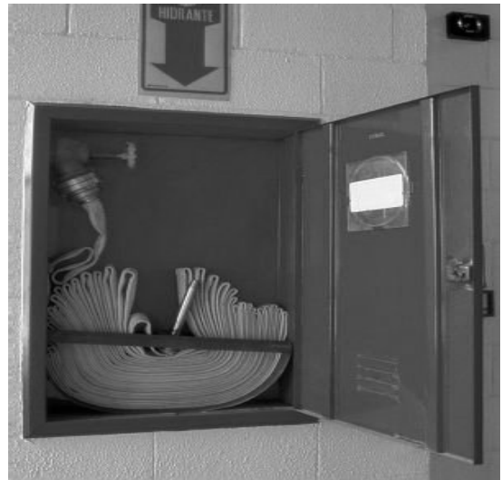
Figura 4 - Sistema de hidrantes
