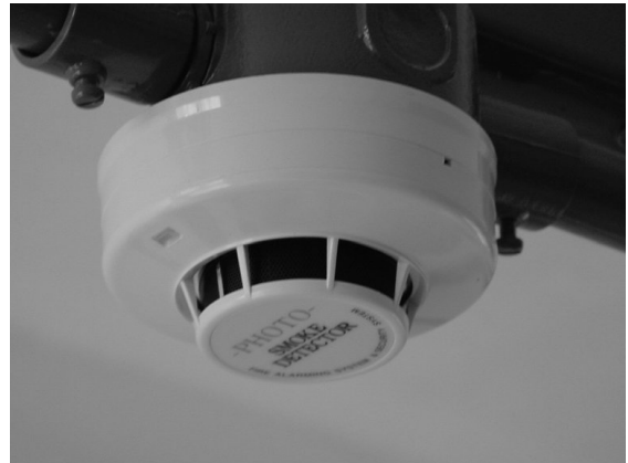
Figura 57 - Detector de incêndio
