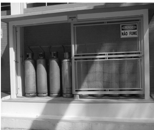
Figura 77 - Bateria de GLP
