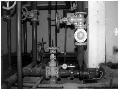
Figura 66 - Bomba de incêndio e acessórios hidráulicos
