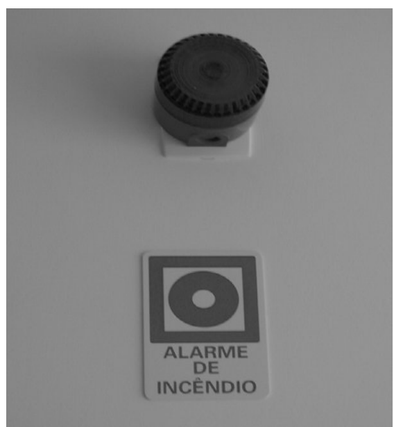
Figura 59 - Detalhe de sirene
