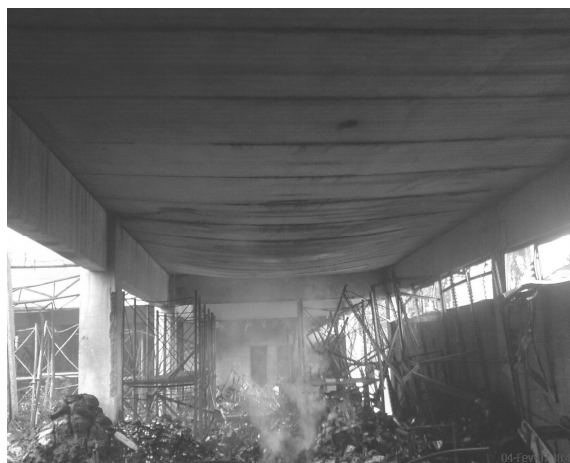
Figura 15 - Incêndio no pavimento
