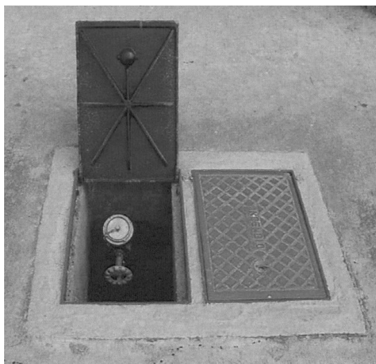
Figura 64 - Registro de recalque para bombeiros
