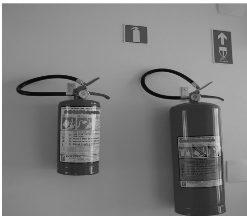
Figura 9 - Extintor de incêndio
