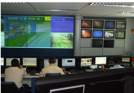
Figura 3 - Central de monitoramento
