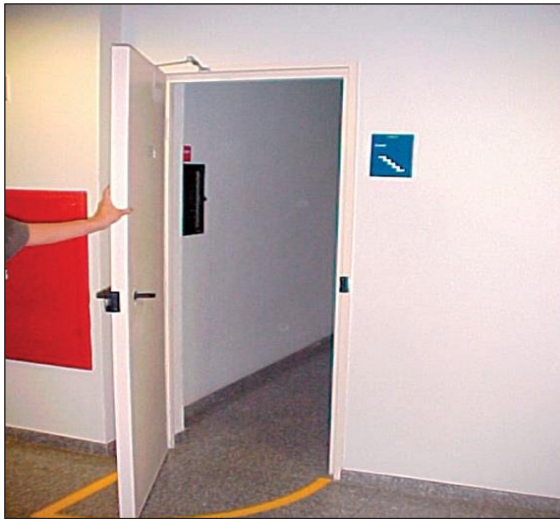
Figura 42: PCF em corredor.
