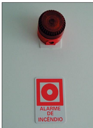
Figura 49: Detalhe de sirene.
